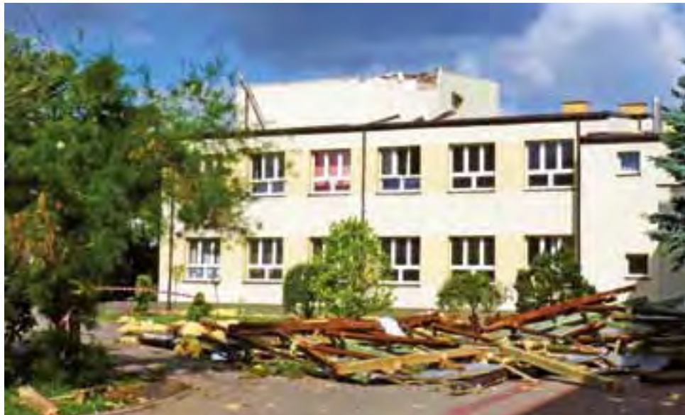
Po nawałnicy. Zerwany dach gimnazjum, zwalone kominy, rumowisko na dziedzińcu – to skutki gwałtownej burzy, jaka w niedzielę wieczorem przetoczyła się nad Bielawami. Stan na poniedziałkowy poranek, 20 lipca.
