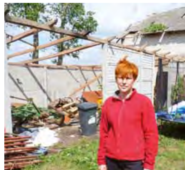
Spustoszone podwórko. Jolanta Borkowska z Borówka na tle tego, co zostało z zadaszonej do niedzieli wiaty gospodarczej. W tle uszkodzona stodoła. Panią Jolanę najbardziej jednak boli strata znacznej części dachu nad domem.
