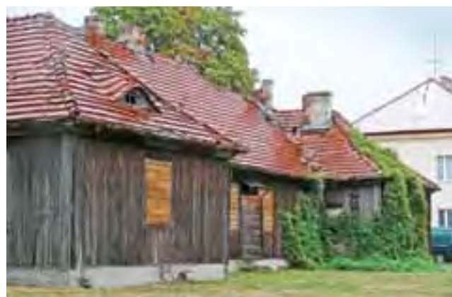
Stan drewnianej konstrukcji alkierzówki po wykonanych specjalistycznych badaniach nie pozostawia wątpliwości, że budynek przy najmniejszej ingerencji, po prostu się rozpadnie.
