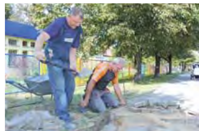
Pracownicy Zakładu Usług Komunalnych w Łowiczu przełożyli kostkę w miejscu, gdzie powstał zapadlisko.
