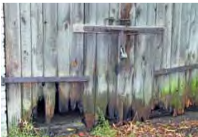
Nadpalone zostały drewniane wrota zabudowań gospodarczych. Gdyby pożar nie został w porę zauważony, mógłby się przenieść na kompleks budynków.
