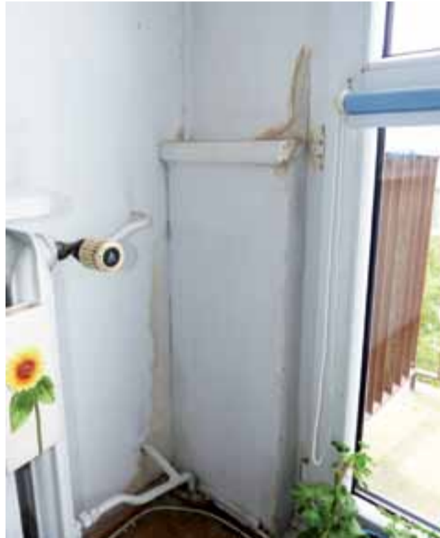
W jednym z mieszkań na IV piętrze powstały zacieki na ścianach w dwóch pokojach. Podobnie jest w innych lokalach.
