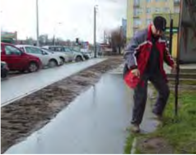
Różnicę poziomów widać gołym okiem. Woda nie ma dokąd spływać.
