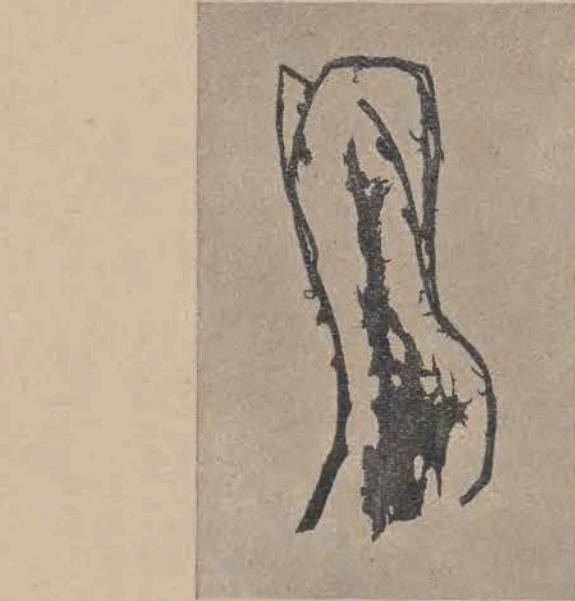
Sznury grzybni „ merulius lacrymans ” pozwalające na przeprowadzenie wody na duże odległości, celem umożliwienia jego rozrostu na wyższych piętrach budynku.
