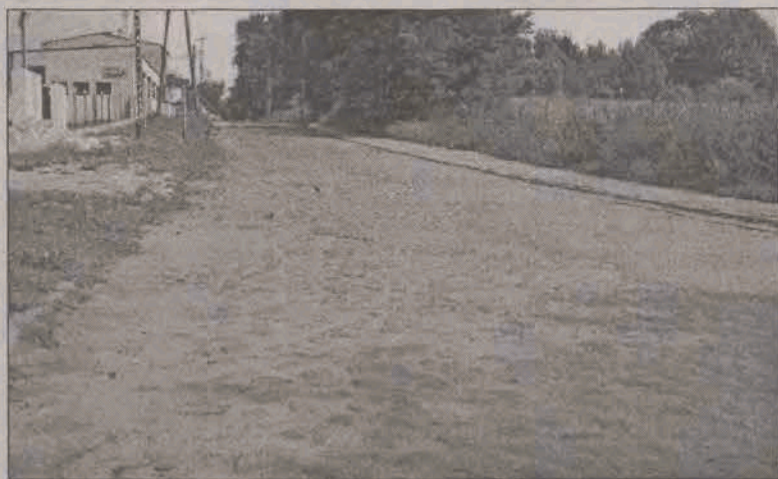
Na ul. Piłsudskiego w Głownie już prawie nie ma asfaltu. Spod jego warstwy wylaniają się „kocie łby”, którymi ulica ta była pokryta wiele lat temu.
