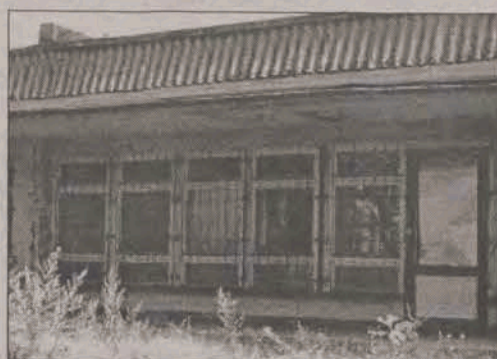
75 tysięcy to kropla w morzu potrzeb. Tyle pochłonie zaledwie wymiana dachu byłego biurowca przy ul. Kościuszki. Kosztów całkowitej adaptacji budynku pod potrzeby mieszkań komunalnych jeszcze nie określono.
