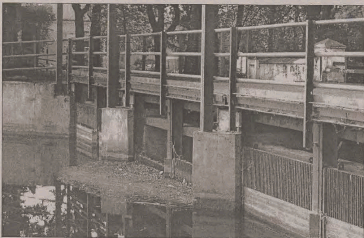
Katastrofa budowlana nie grozi, ale jeździć już tędy nie wolno.
