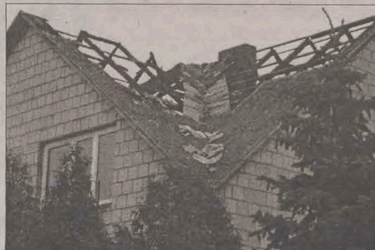
Tak wygląda dom ze spalonym dachem. Nadchodzące święta mieszkańcy spędzą poza domem.
