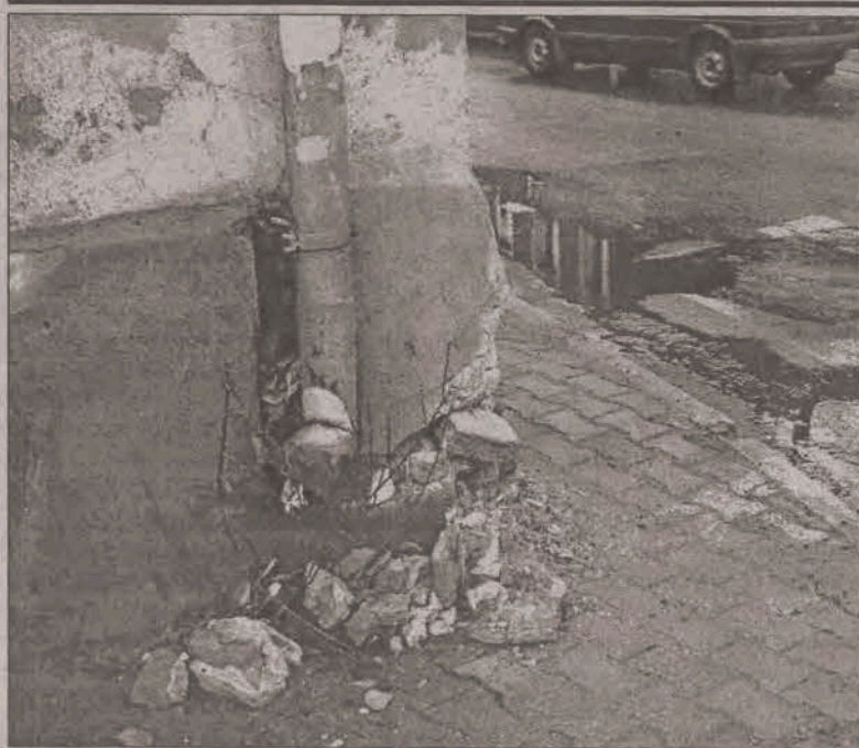
Budynek komunalny u zbiegu ulic Łowickiej i Bielawskiej w Głownie zaczyna zamieniać się w gruz. Cegły z narożnika domu skutecznie utrudniają przejście na i tak już bardzo wąskim odcinku chodnika. (ljs)
