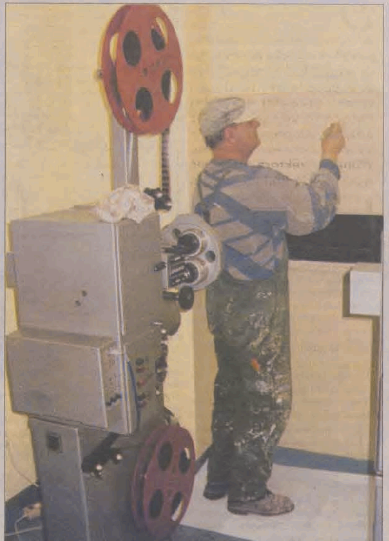
W kabine projekcyjnej na ulicy Podrzecznej zostały już ustawione projekctory odkupione od szkoły na Blichu.
