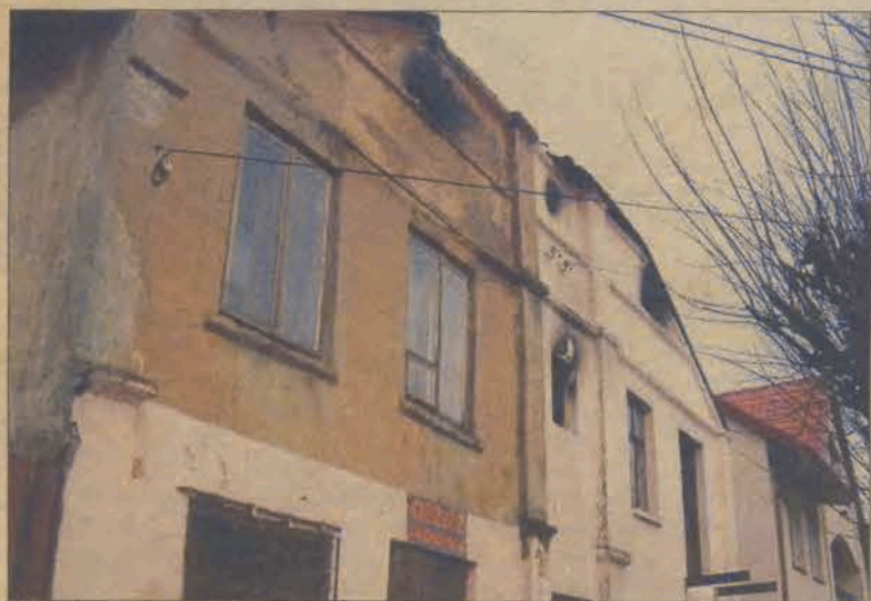
Świadectwem pożaru kamienicy przy Pl. Łukasieńskiego 19 są okopcone okienka poddasza, które uległo doszczętnemu spalaniu.
