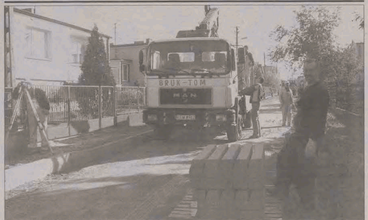
UTWARDZAJĄ STASZICA I ORZESZKOWEJ. Jeszcze tylko przez kilka dni drogowcy z firmy Erbedim pracować będą na ulicach Staszica i Orzeszkowej w Strykowie. Asphalt ma się tu pojawić najdalej 31 października. Sezon inwestycyjny powoli się kończy, a wraz z nim modernizacje dróg w mieście i gminie Stryków. (ljs)
