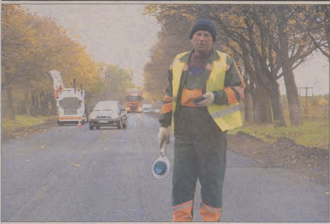
DO ŁODZI CZARNYM SZLAKIEM. Trwa modernizacja trasy krajowej nr 14. Na odcinku z Głowna do Bratoszewic póki co zamieniła się ona w czarny szlak bez osi jezdni i pasów ograniczających pobocze, które były frezowane wraz ze starą nawierzchnią. Brak oznakowania pionowego oraz wahadłowa sygnalizacja ruchu powodują, że kierowcy powinni tu być bardzo ostrożni. Ubiegłotygodniowy karambol w Wysokach jest najlepszym tego dowodem. (ljs)
