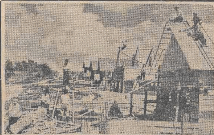
Zniszczone przez barbarzyńców hitlerowskich kraje Europy Wschodniej odbudowują się w szybkim tempie. Na gruzach miast i wsi powstają tysiące nowych domów. Na ilustracji odbudowa zniszczonych wsi na Białorusi radzieckiej
