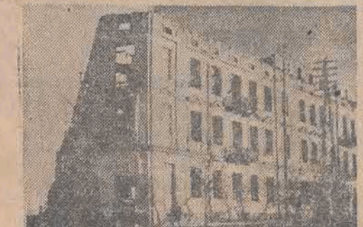
Dom, który napróżno oczekuje remontu na rogu ul. Armii Czerwonej i Św. Antoniego. Może przeniesie się do Warszawy, to tam go wyremontują!
