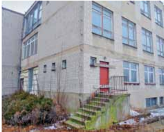
Budynek po dawnej szkole w Lwówku jest w coraz gorszym stanie. Stoi pusty od wielu lat, więc zostanie rozebrany.
