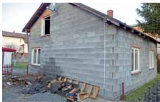
Pożar wybuchł na poddaszu budynku, rozprzestrzenił się na dach.
