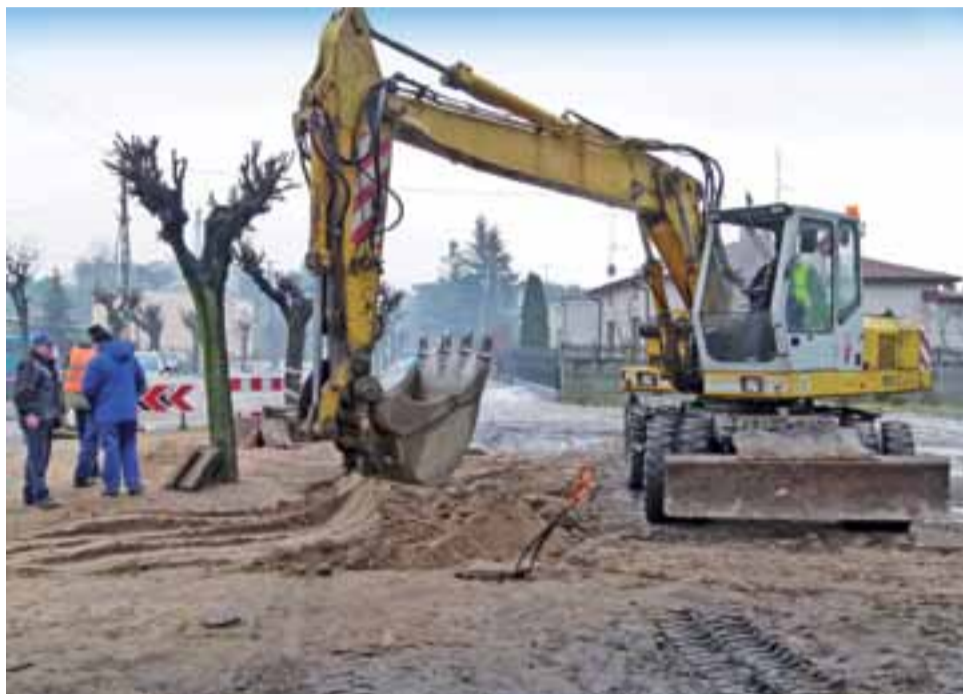
Porządkowanie miejsca, w którym doszło do pęknięcia rury, trwało jeszcze w poniedziałek.
