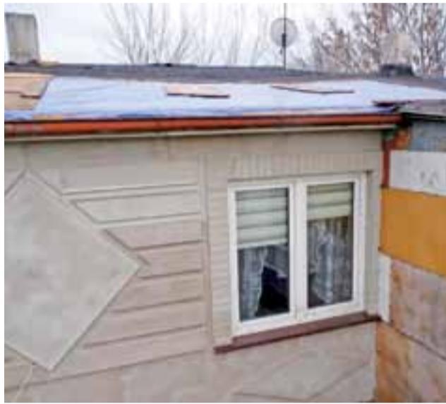
Dach nad pokojem. Uszkodzony w czasie pożaru dach domu przy ul. Myśliwskiej prowizorycznie zabezpieczono folią.
