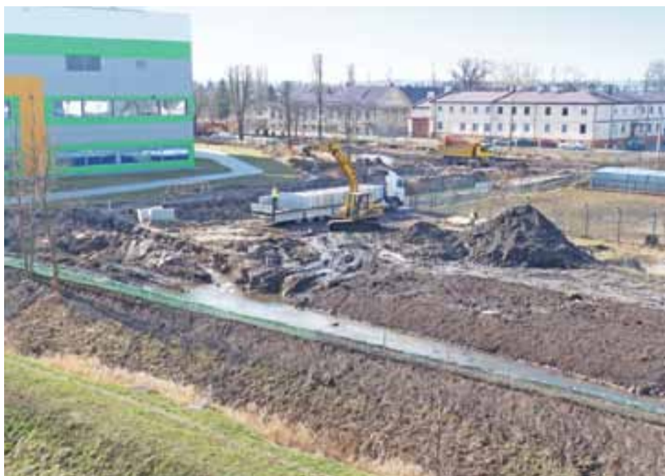
Prace nad korytem Bobrowki, mniej więcej w połowie realizacji. Widok z dachu biurowca zakładu z 25 lutego.
