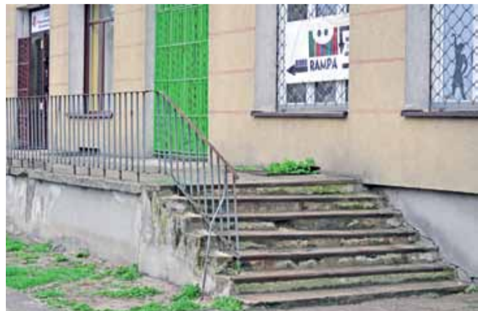
Schody i rampa przed blokiem na Kostce są w kiepskim stanie. Blok należy też umyć.
