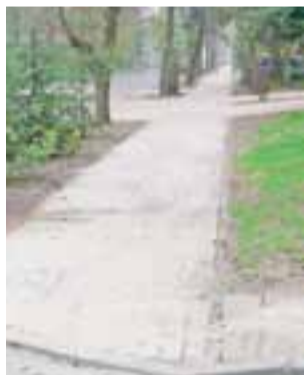
Chodnik przy ul. Legionów w końcu jest równy i nie zagraża przechodniom potknięciem się o wystający element.
