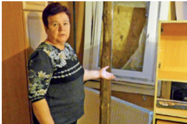
Pani Barbara obawia się o konstrukcję dachu, który trzeba było podprześć drewnianymi belkami.
