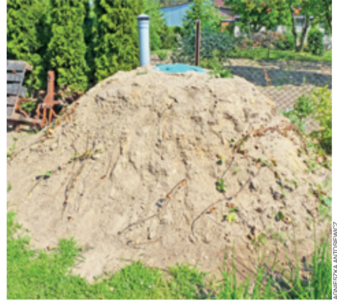
Tak wygląda kopiec przydomowej oczyszczalni ścieków.
