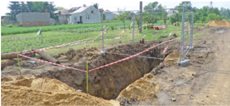
Na ul. Strzelczewskiej pracownicy ZUK budują sieć kanalizacji sanitarnej na długości około kilometra.
