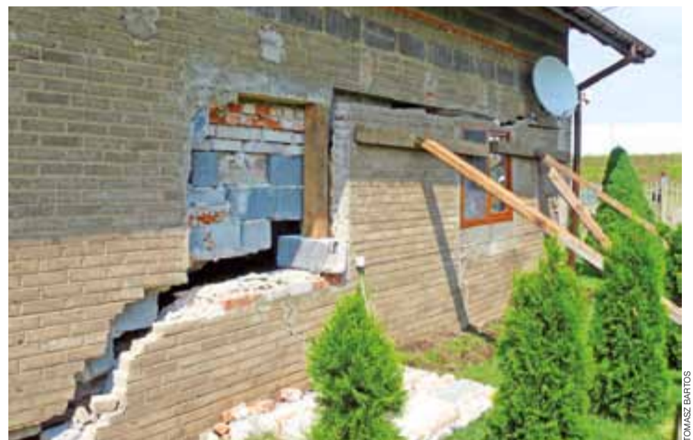
Podparta przez strażaków ściana budynku, która osunęła się w wyniku podmycia przez wodę.
