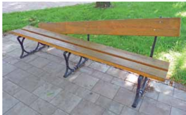
Ławki mają uszkodzone żeliwne elementy łączące siedzisko z oparciem. Zostały prawdopodobnie przecięte ostrym narzędziem.
