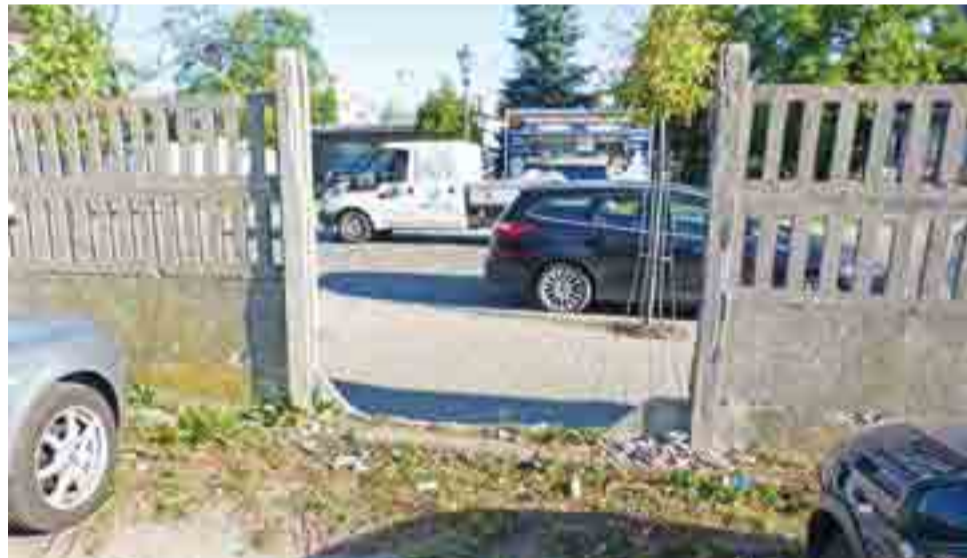
Wytłuczone betonowe płyty sprawiły, że w ogrodzeniu powstało dodatkowe wejście z ul. 3 Maja na parking.
