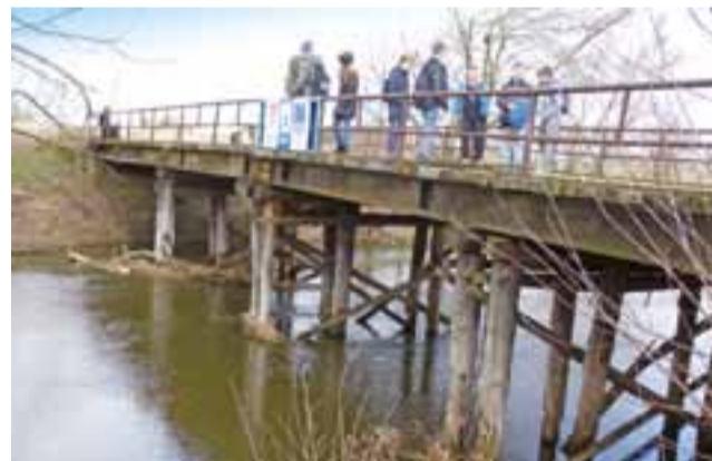
Drewniany most w Klewkowie niedługo zostanie rozebrany. To zdjęcie wykonaliśmy jeszcze wiosną, ale już wtedy widać było, że konstrukcja jest coraz mniej bezpieczna.
