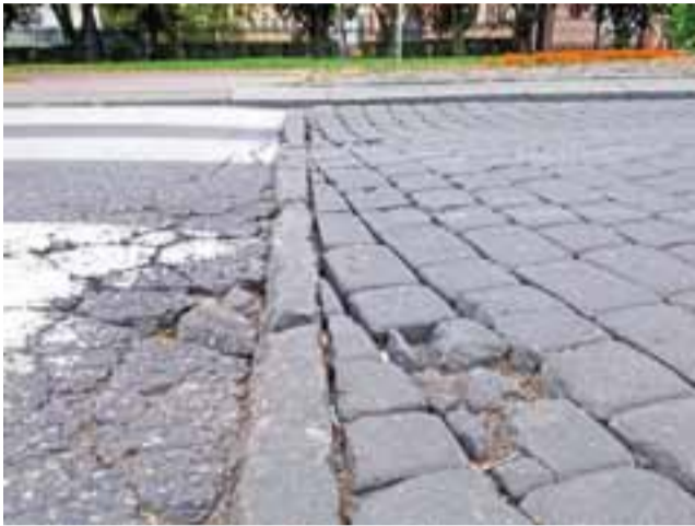
Miejsce połączenia asfaltu z betonową kostką, z której wykonane jest rondo – na zdjęciu widać pokruszony asfalt i zniszczoną kostkę.
