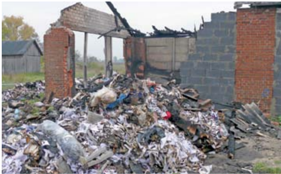
Pogorzelisko w Bielawach , obecnie po budynku gospodarczym pozostały tylko ściany, to, co leży na ziemi, to półprodukty do szycia strojów kąpielowych.
