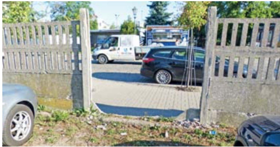
Betonowy mur nie jest w najlepszym stanie technicznym. Całkiem niedawno z parkingu stoczył się na niego samochód, niszcząc betonowe płyty między przestami.
