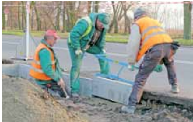
Pracownicy ZUK 23 listopada zajęci byli zagęszczaniem podbudowy oraz układaniem krawężników przy poszerzanych parkingach.
