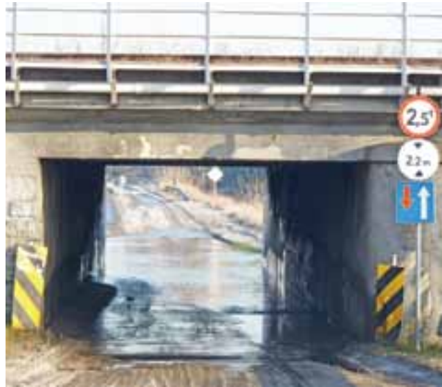
Wiadukt na ul. Arkadyjskiej kolejny już raz został zalany przez wodę z rzeki Zwierzyniec.
