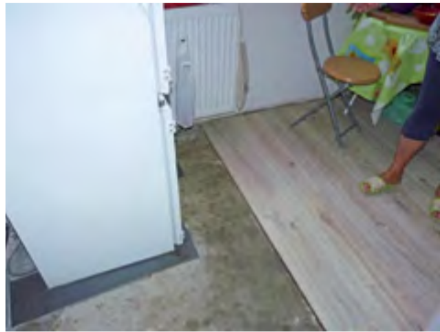
Tak wygląda podłoga w mieszkaniu pani Teresy – gdzieś tam, np. pod szafkami, zostały jej niewielkie fragmenty, ale na większości powierzchni – jej nie ma.
