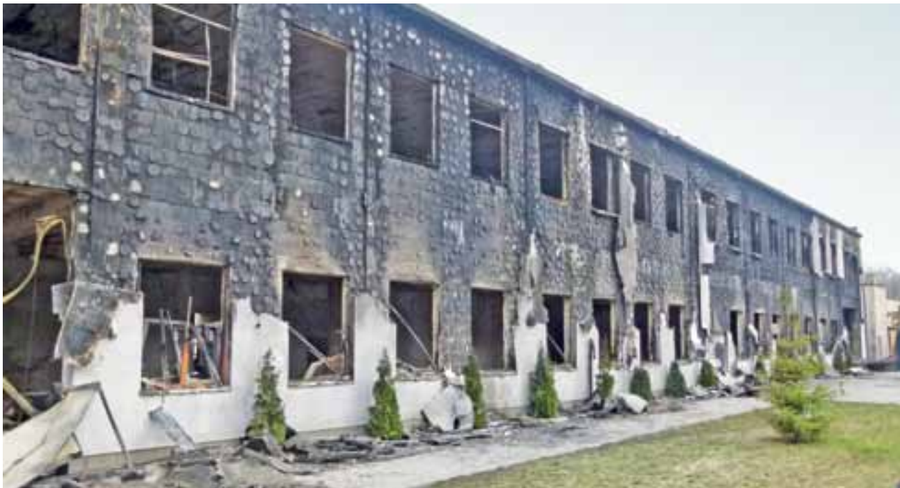
Pożar spowodował ogromne straty. Zabudowania przy Leśnej w ciągu jednej nocy stały się ruiną.
