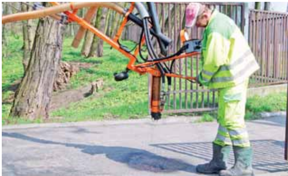
Łatanie dziur przy pomocy maszyny wtryskującej na terenie Urzędu Stanu Cywilnego przy ul. Dworskiej
