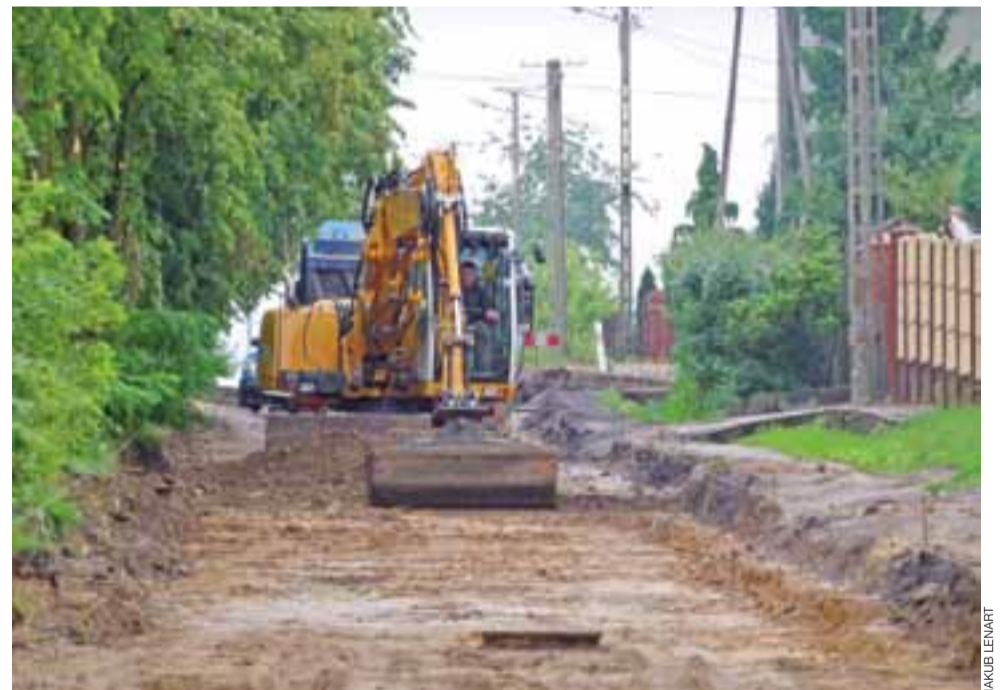
Prace przy ul. Dworskiej przebiegają sprawnie i jest szansa na to, że skończą się przed terminem.
