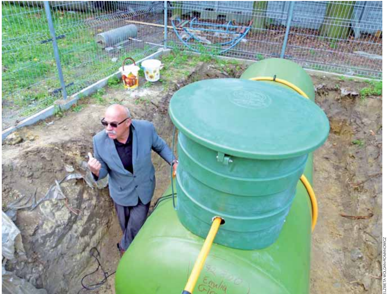
Inwestycja nieplanowana, lecz konieczna. W Popowie Głowieńskim wymieniono szkolny zbiornik na propan butan. Obok zbiornika wójt Marek Józwiak.
