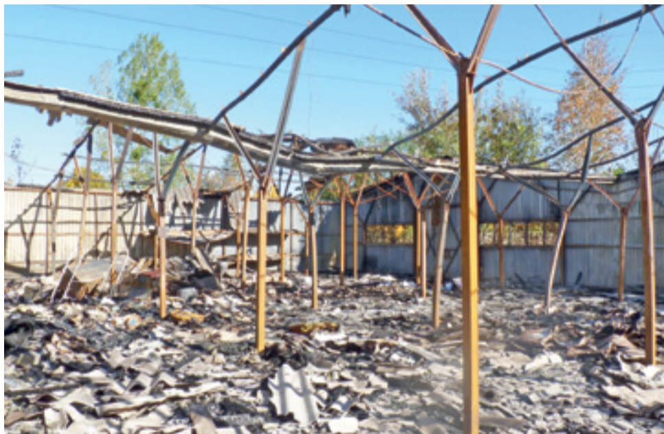
Wnętrze spalonej hali. Budynek, w którym składowane były bele sprasowanej makulatury, nie nadaje się do eksploatacji. Stan na 4 października.
