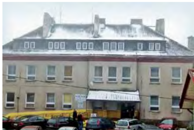
Dach na budynku ośrodka zdrowia w Sannikach nadaje się do generalnego remontu.
