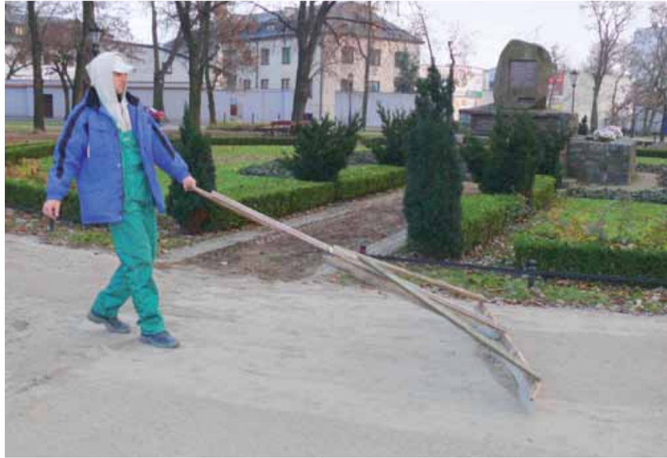
Nawierzchnia mineralna na ścieżkach w parku Sienkiewicza została całkowicie wymieniona i od nowa wyprofilowana ze spadkami, aby nie stała na niej woda.
