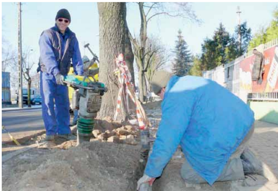
Pracownicy firmy Eurogaz w czasie utwardzania ziemi w miejscu, gdzie rozebrana była nawierzchnia, chodnika przy układaniu sieci gazowniczej.
