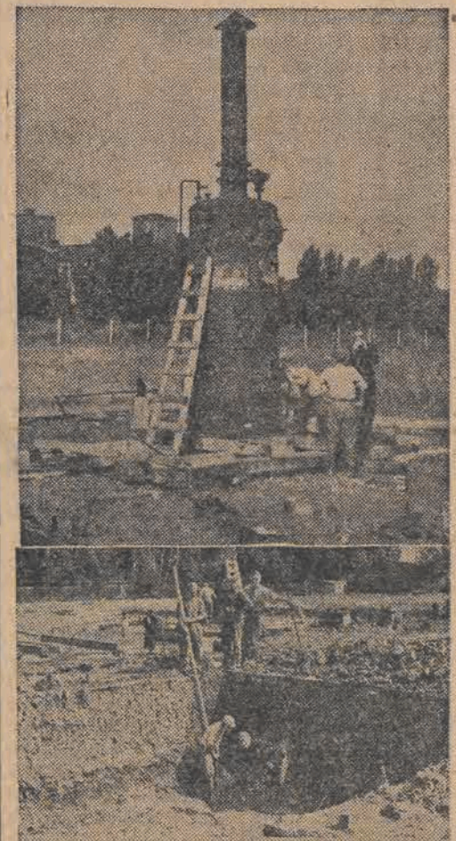
Prace ziemne przy budowie hali sportowej w Łodzi, szybko posuwają się naprzód.
