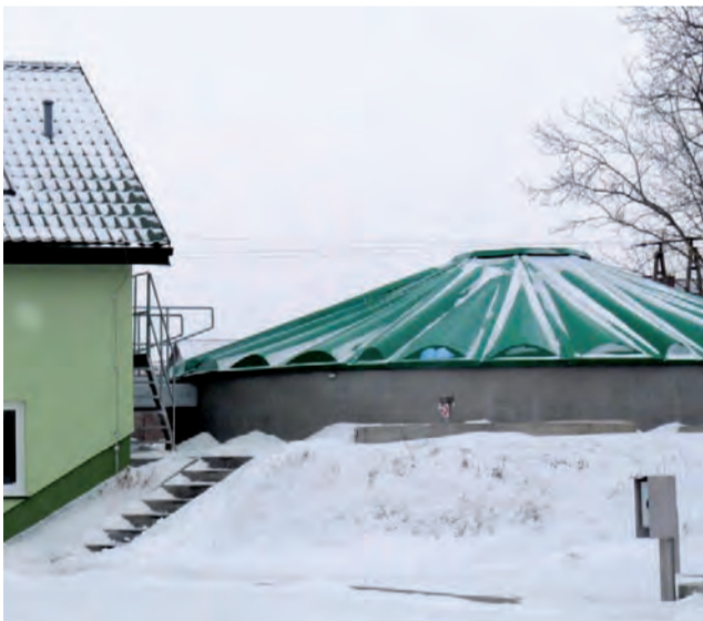
Mimo mrozów i śniegów oczyszczalnia ścieków w Kiernozi cały czas działała bez zastrzeżeń.
