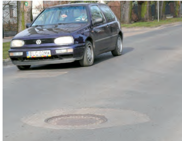
Studzienki kanalizacji sanitarnej w ulicy Armii Krajowej w większości są pozapadane co komplikuje kierowcom jazdę.
