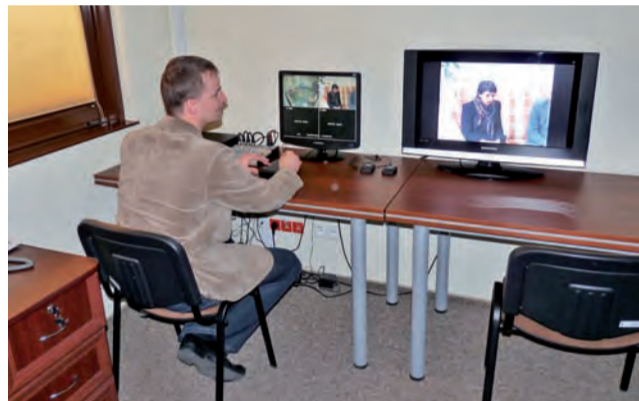
W pokoju technicznym zainstalowane są urządzenia do odbioru wizji i fonii z dziecięcego „niebieskiego pokoju”.
