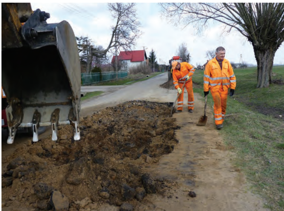
Ubytki w asfalcie są bardzo duże. Obecnie są one usuwane, uzupełniane nowym tłuczniem i utwardzane. Konieczne będzie położenie nowego asfaltu.
