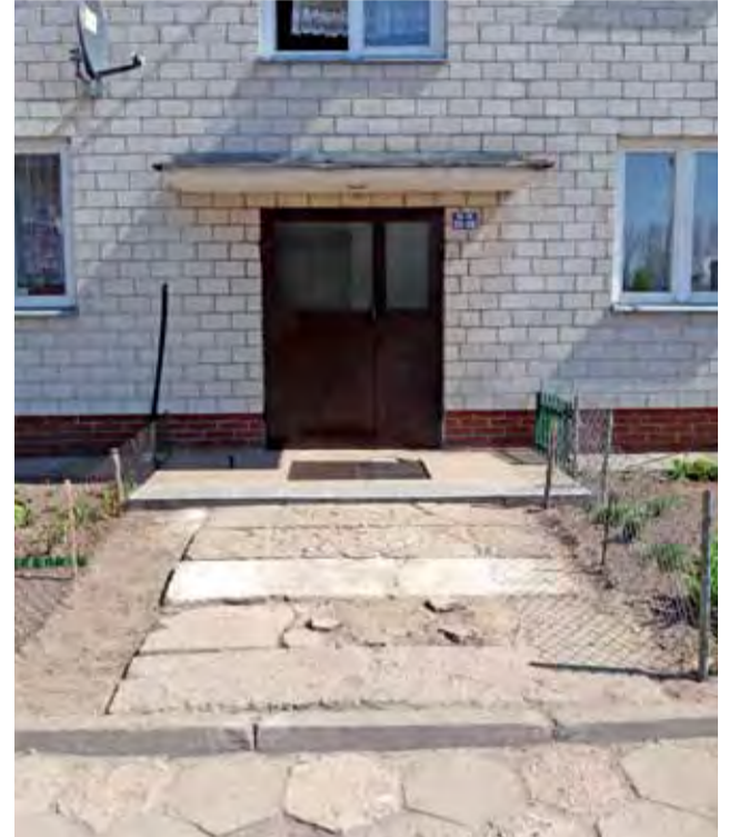
Wejście bloku przy ul. A. Krajowej 43M pozostawia wiele do życzenia.
