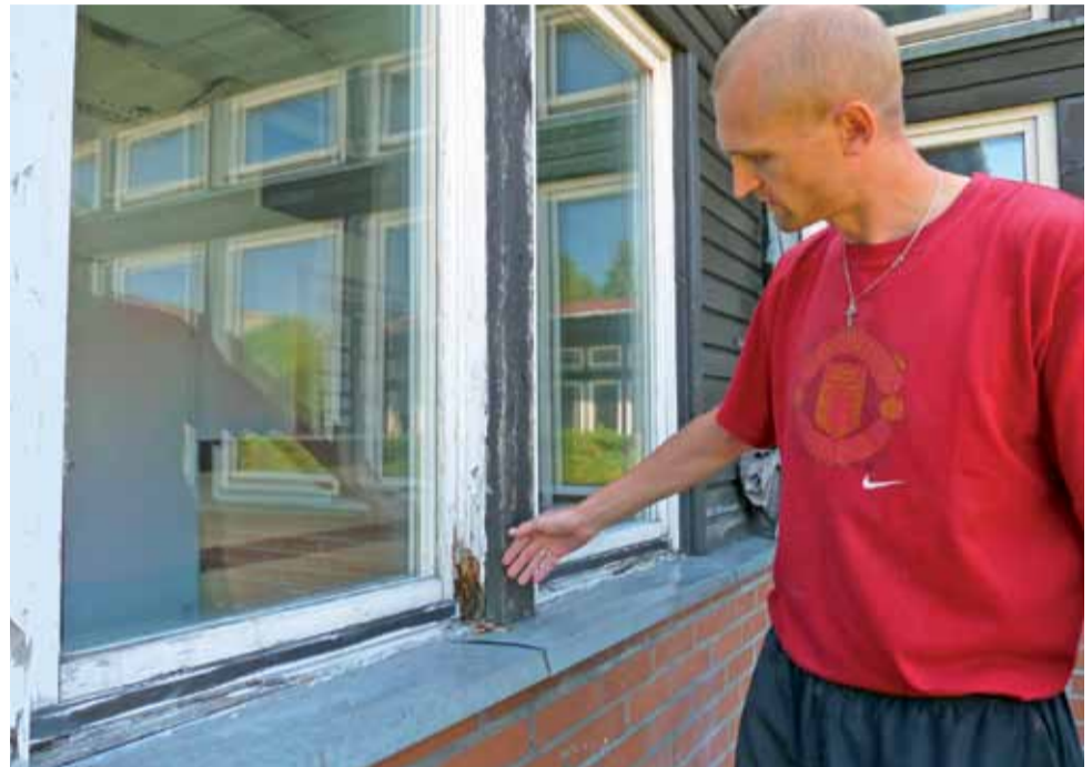
To, że szkolne okna potrzebują remontu widać gołym okiem. Ubytki we framudze pokazuje, rehabilitant Rafał Gajda, który w wakacje nadzoruje szkolne remonty.
