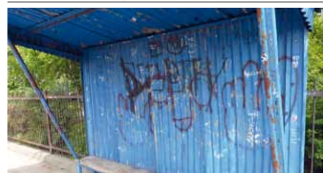
Blaszana wiata nieczynnego już przystanku autobusowego MZK przy ogrodzeniu Zespołu Szkół na Korabce nie dodaje ulicy Legionów uroku. Niebieska blacha wiaty jest powyginana, konstrukcja sprawia wrażenie dawno zapomnianej – i czekającej na naprawę. mak
