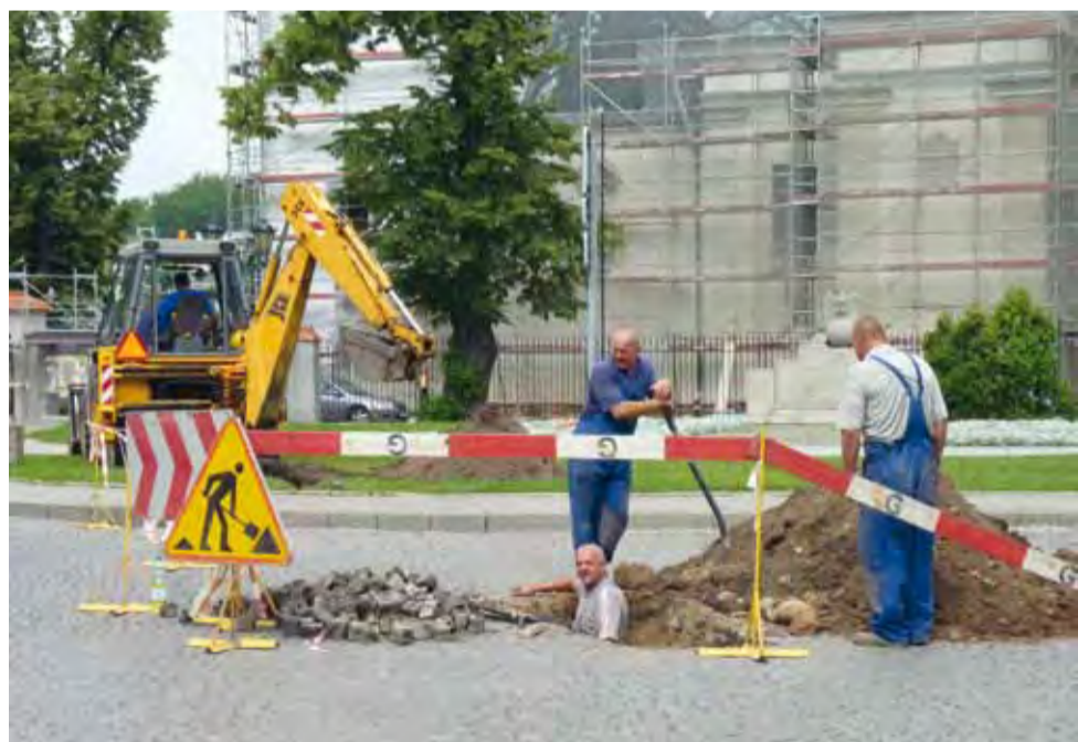
Choć doły zostały wykopane na środku ulicy, samochody mogły bez problemu je ominąć.
