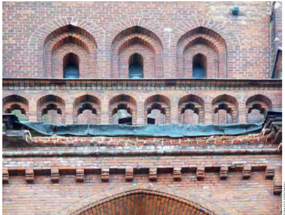
Uszkodzenia spowodowały oberwanie się gzymsu. Został on zabezpieczony przez strażaków.
