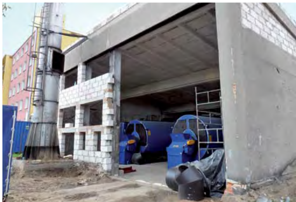
Po starej kotłowni zostanie tylko komin i część ścian. W środku stoją już nowe piece na miał.
