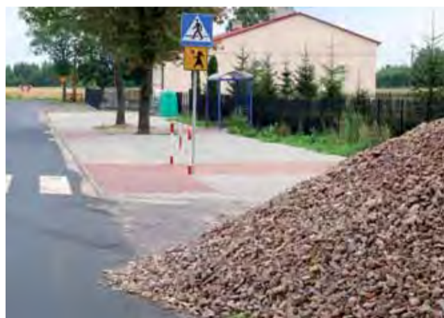
Prace przy budowie chodnika przy OSP w Mysłakowie rozpoczną się na dniach, tłuczeń na podbudowę został już przywieziony.
