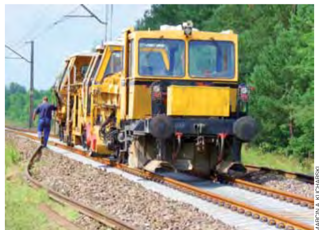
Po remonowanych torach kilkakrotnie przejeżdżały specjalistyczne pociągi techniczne. Jedne wymieniały podkłady i szyny, inne prostowały i „podbijały” tor.
