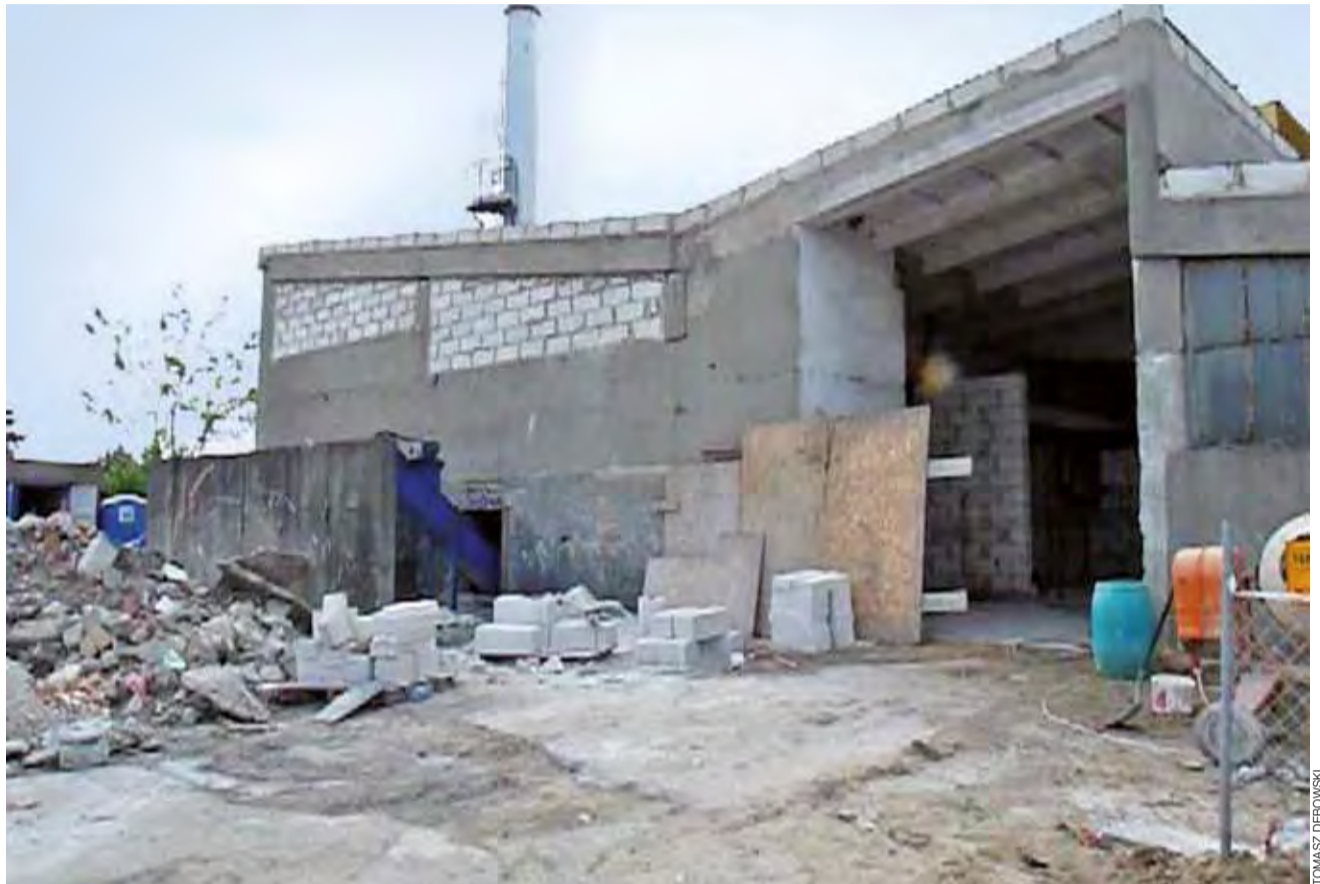
Grzegorz Haraśny ma pomóc w pozyskaniu pieniędzy z zewnątrz, m.in. na takie inwestycje jak przebudowa kotłowni na os. Konopnickiej.
