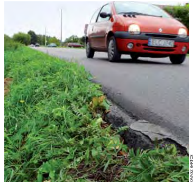
W jednym miejscu pobocze ul. Arkadyjskiej w Łowiczu praktycznie nie istnieje, stromo opada ono w stronę koryta Zwierzynicy.
